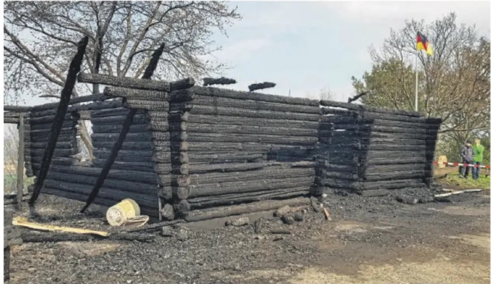
Ein Bild des Jammers: Von der alten Küllbergshütte blieben nach dem Brand im April nur Ruinen. Der Kulturverein Harle will die Hütte nun wieder aufbauen. Spenden sind willkommen.
