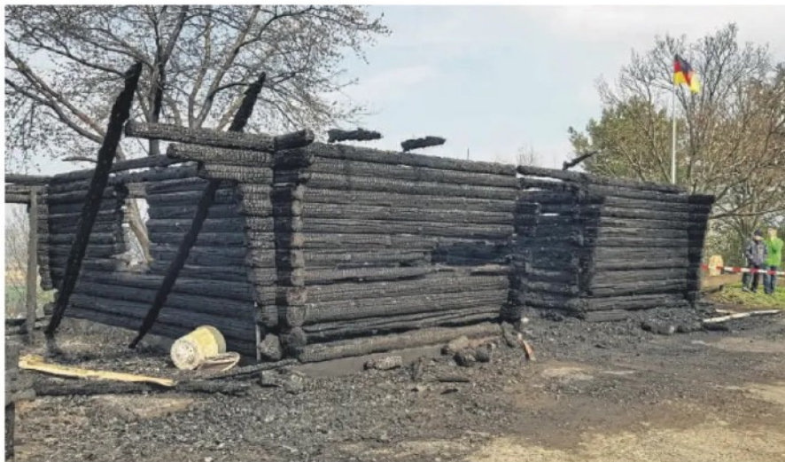
Ein Bild des Jammers: Von der alten Küllbergshütte blieben nach dem Brand im April nur Ruinen. Der Kulturverein Harle will die Hütte nun wieder aufbauen. Spenden sind willkommen.
