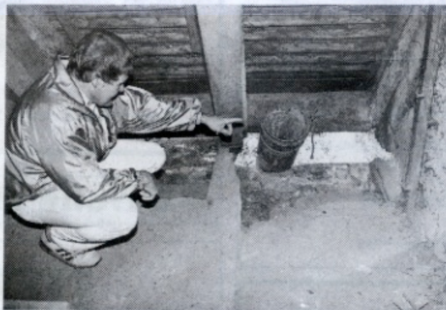
Blick durch die Decke ins Freie! Pfarrer Hans-Helmar Auel zeigt die durchgefaßten Balkenköpfe.
